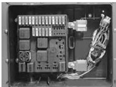
Boîte à fusible
