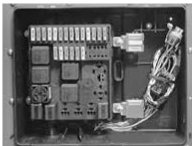
Boîte à fusible
